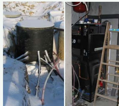
Foto: Peder Vejsig Pedersen, Cenergia Jordslanger samt varmepumpe
