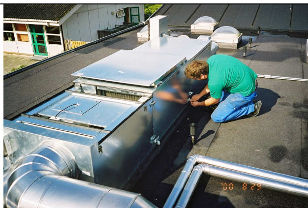
Anlæg monteret på fladt tag.
